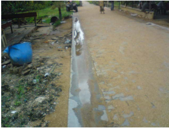
Verzakking V-goten Javanenweg wegens niet gehouden afspraken buurtbewoner
