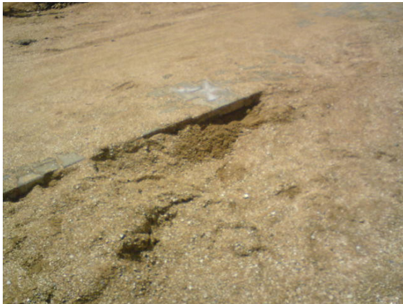
Geen opsluitband aanwezig, deze is helemaal gezakt en niet meer zichtbaar.
